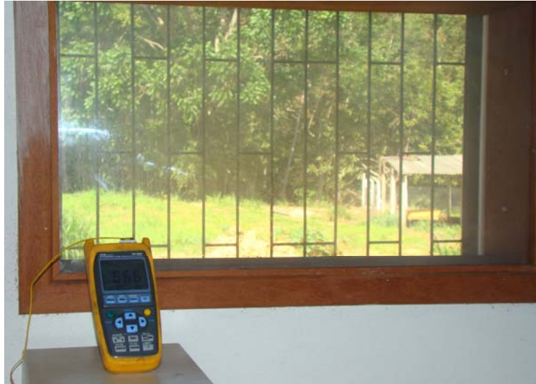
Figura 4. Termômetro com datalogger, instalado na sala com isolamento acústico.
