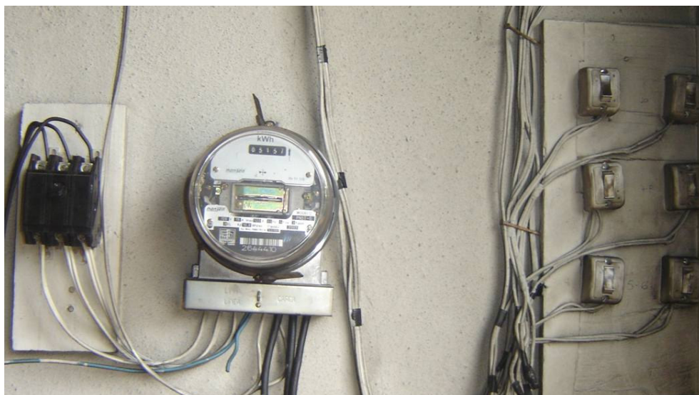
Figura 3. Medidor de energia e sistema para controle de carga no motor.
